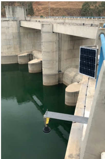
Radar sur barrage Sidi Mohamed-Ben-Abdellah.
