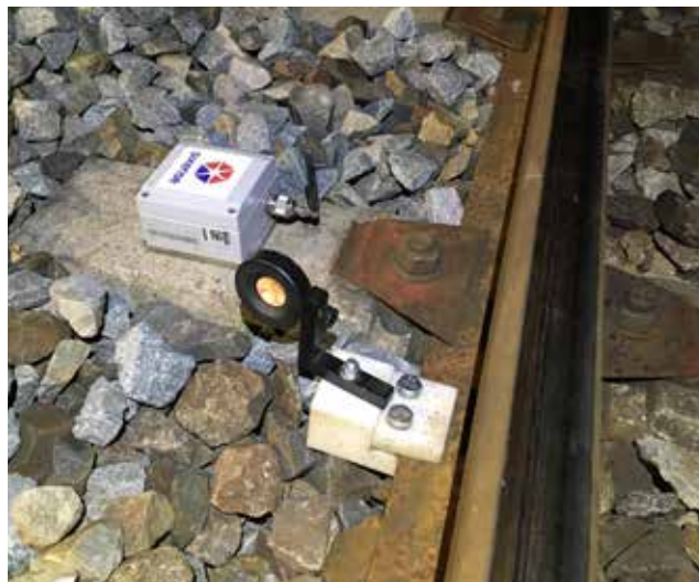
Zoom : Rail Serenity déployé sur une voie ferroviaire : capteur tiltmètre et prisme d'auscultation.
