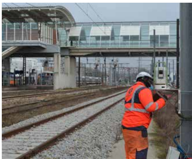
Calibration du système Cyclops à la gare de Massy-Palaiseau.
